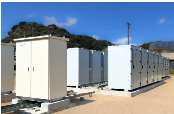
NC 唐津市相知町蓄電所 写真①
