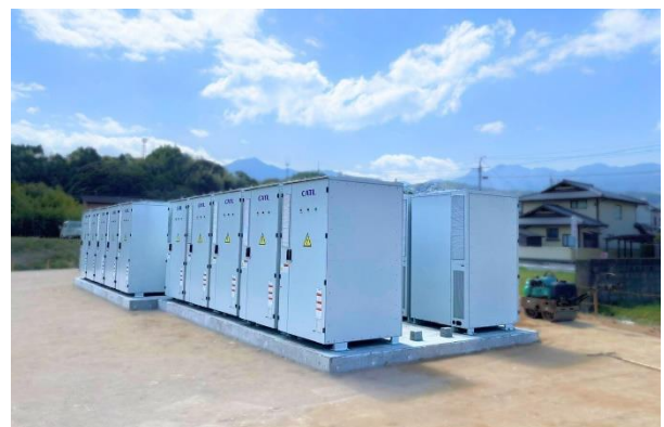
NC 唐津市相知町蓄電所 写真②
