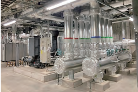
福岡大学病院本館ES事業機械室 エネルギー
