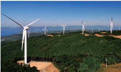
串間風力発電所
