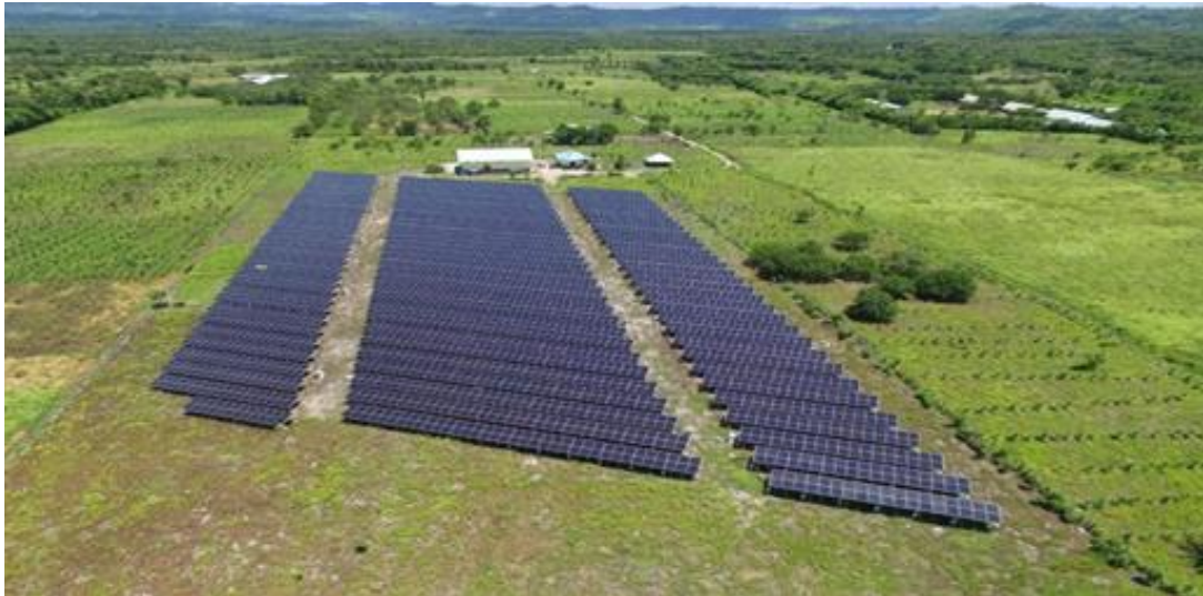
実証実験施設の全景
